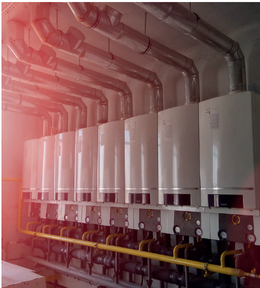
Exemple de mise en place de chaudières à condensation modernes.
