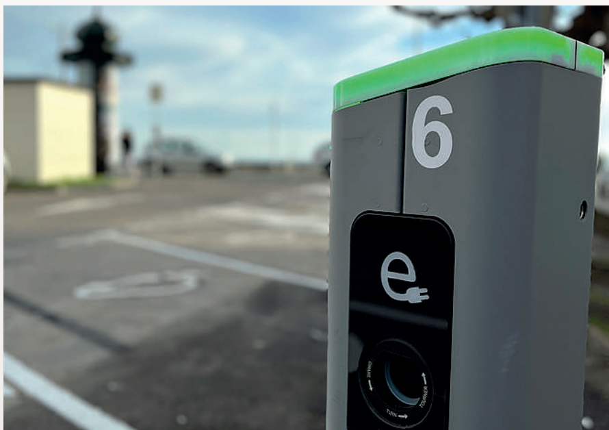
Station de recharge de La Baule-Escoublac.
